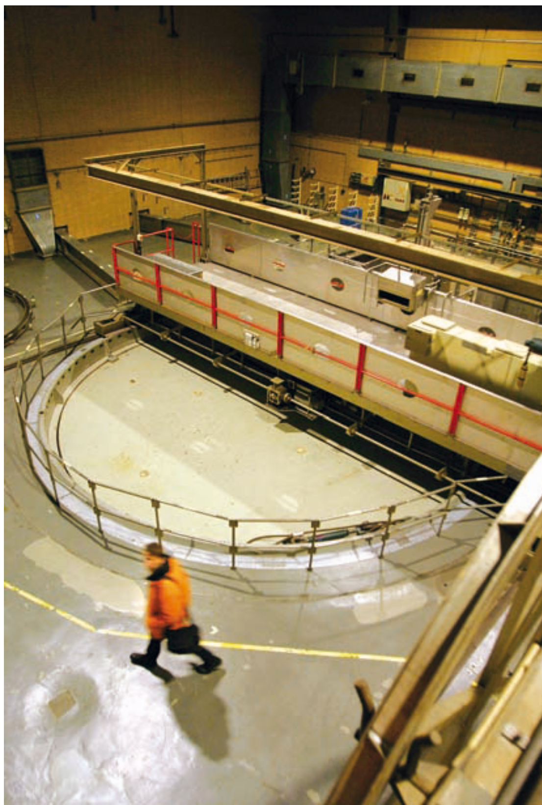
Het interieur van de 'ingesloten' kerncentrale in Dodewaard. Rechtsboven inspecteert Dick Kers een onderdeel van de reactor, die sinds 1997 niet meer in gebruik is
